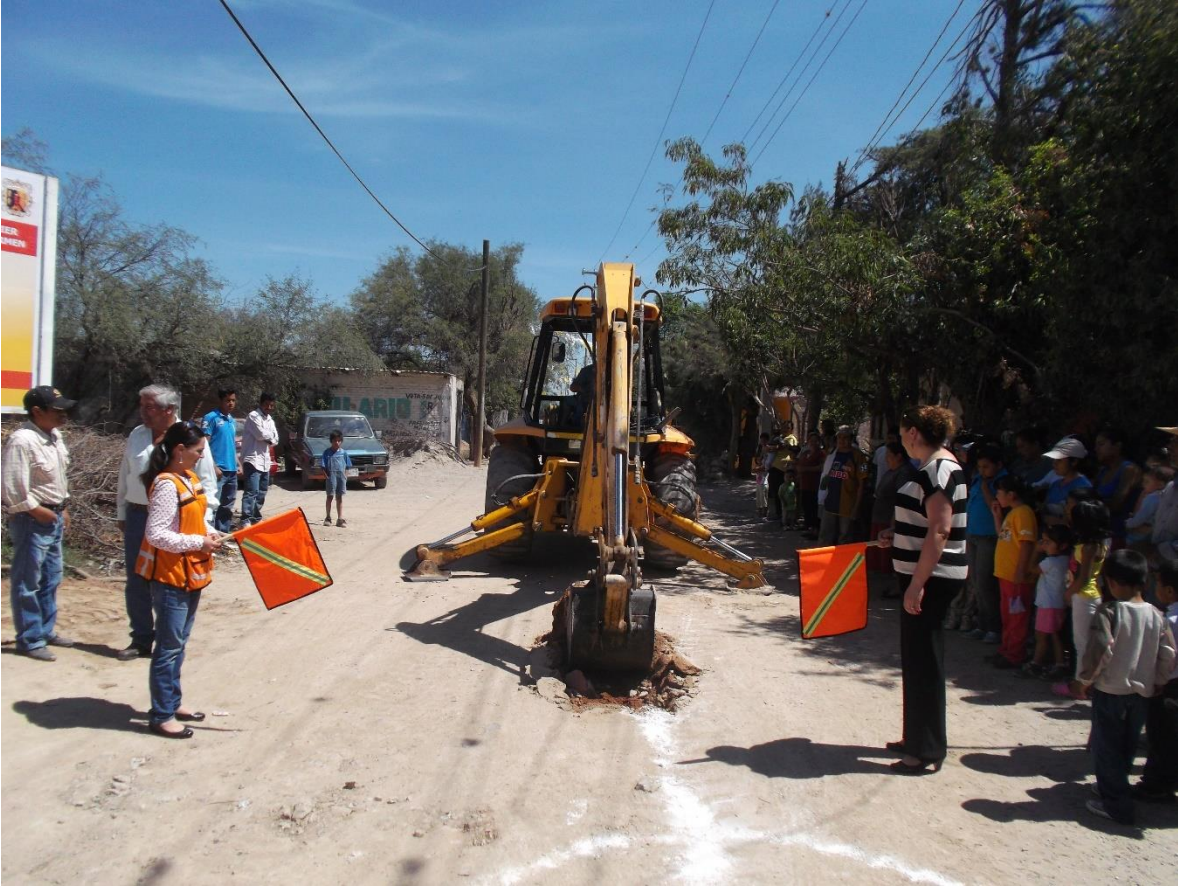
BANDERAZO DE INICIO DE LA OBRA CONSTRUCCIÓN DE DRENAJE EN LA COMUNIDAD PLANTA DEL CARMEN.
