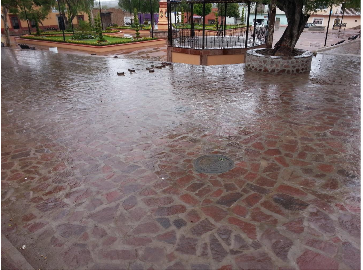
REHABILITACIÓN DE RED DE DRENAJE Y AGUA POTABLE, PAVIMENTACIÓN DE CALLE MORALES, COMUNIDAD DE PORTEZUELO.
