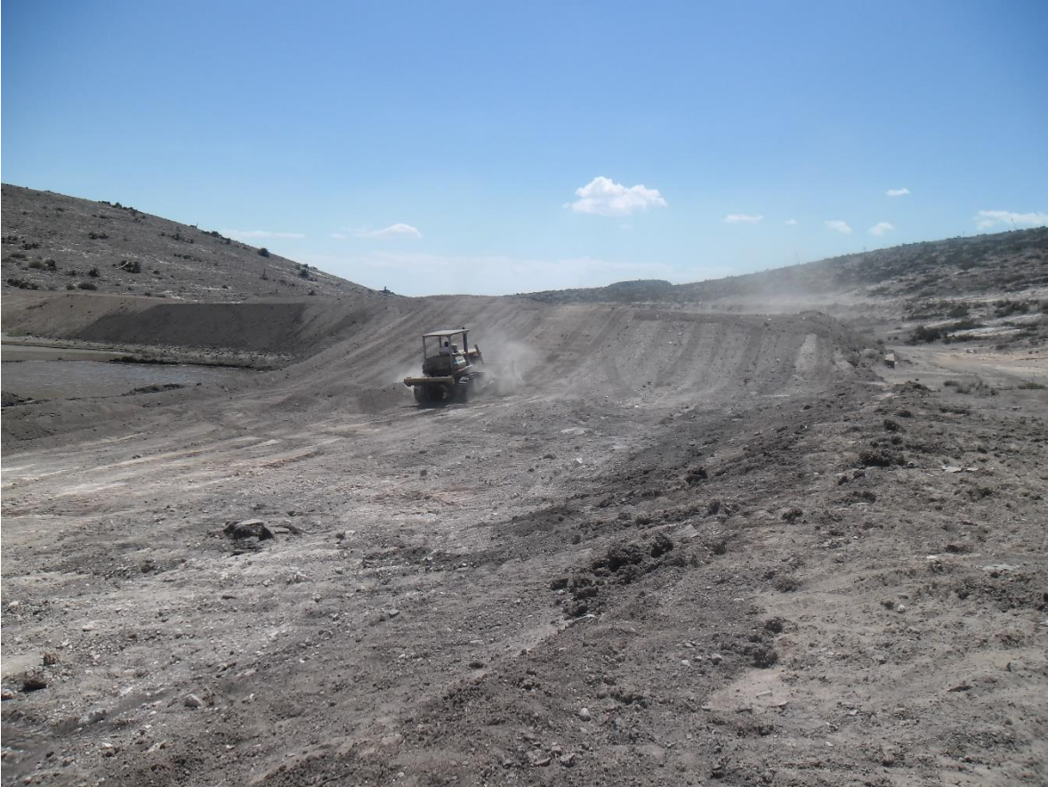
DESAZOLVE DE ESTANQUES, PRESAS Y CONSTRUCCIÓN DE BORDOS. PRESA DERRAMADEROS, COMUNIDAD CUESTA DE CAMPA.
